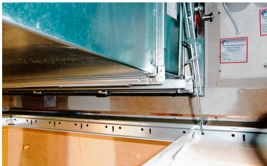
In het plenum worden alle doorvoeren door de brandscheiding brandwerend afgedicht, gestickerd en geregistreerd in een logboek. (Foto: KLF)
