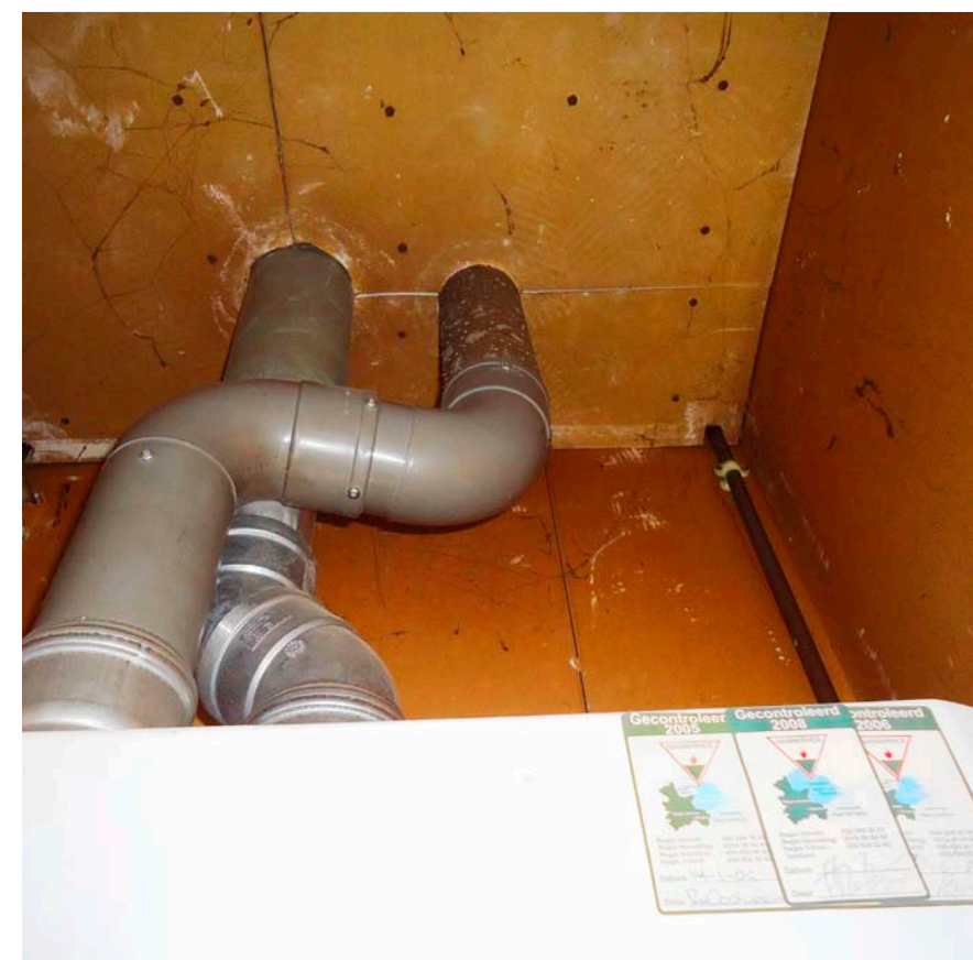
Brandveilige kunststof en aluminium buisdoorvoeren bij gestapelde woningbouw. Dit is eenvoudig te herstellen door brandmanchetten en schaaldelen te plaatsen rondom de buizen.
