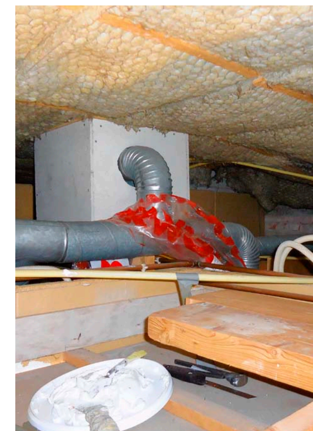
De mechanische ventilatie is geplaatst in een ombouw, maatregelen zijn nodig om brandwerendheid te garanderen.
